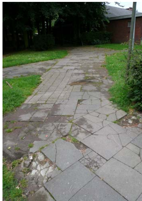
L'état de ce piétonnier s'est encore largement dégradé depuis la photo qui date de 2007 !
